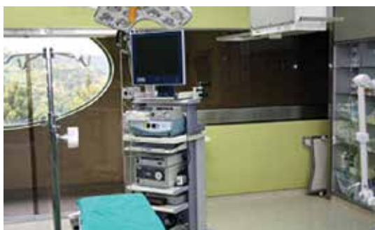
Nova operacijska dvorana (iz arhiva SB Izola, n. d.).
